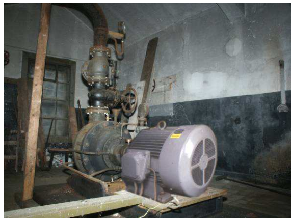
Abb. 20 Ein Loch im Fenster des Pumpwerks gab den Blick auf die alte Pumpe mit einem modernen Elektromotor frei
