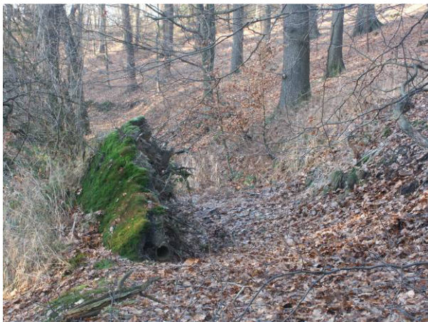
Abb. 29. Herbststürme warfen einen Baum um, dessen freigelegte Wurzel den Blick auf ein gußeisernes Druckrohr preisgab
